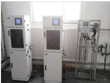
废水在线设施
