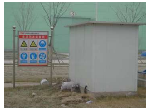
生活污水设备间
